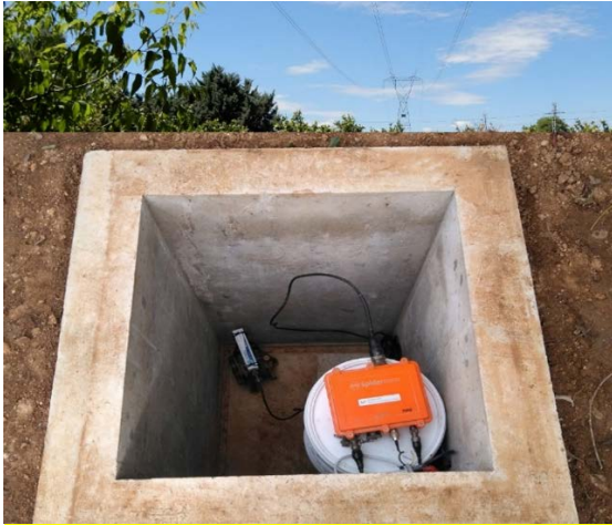
Fig. 13. Instal·lació d'un magnetòmetre sota la línia de 400 kV Vandellòs-La Plana. Instalación de un magnetómetro bajo la línea de 400 kV Vandellós-La Plana.
